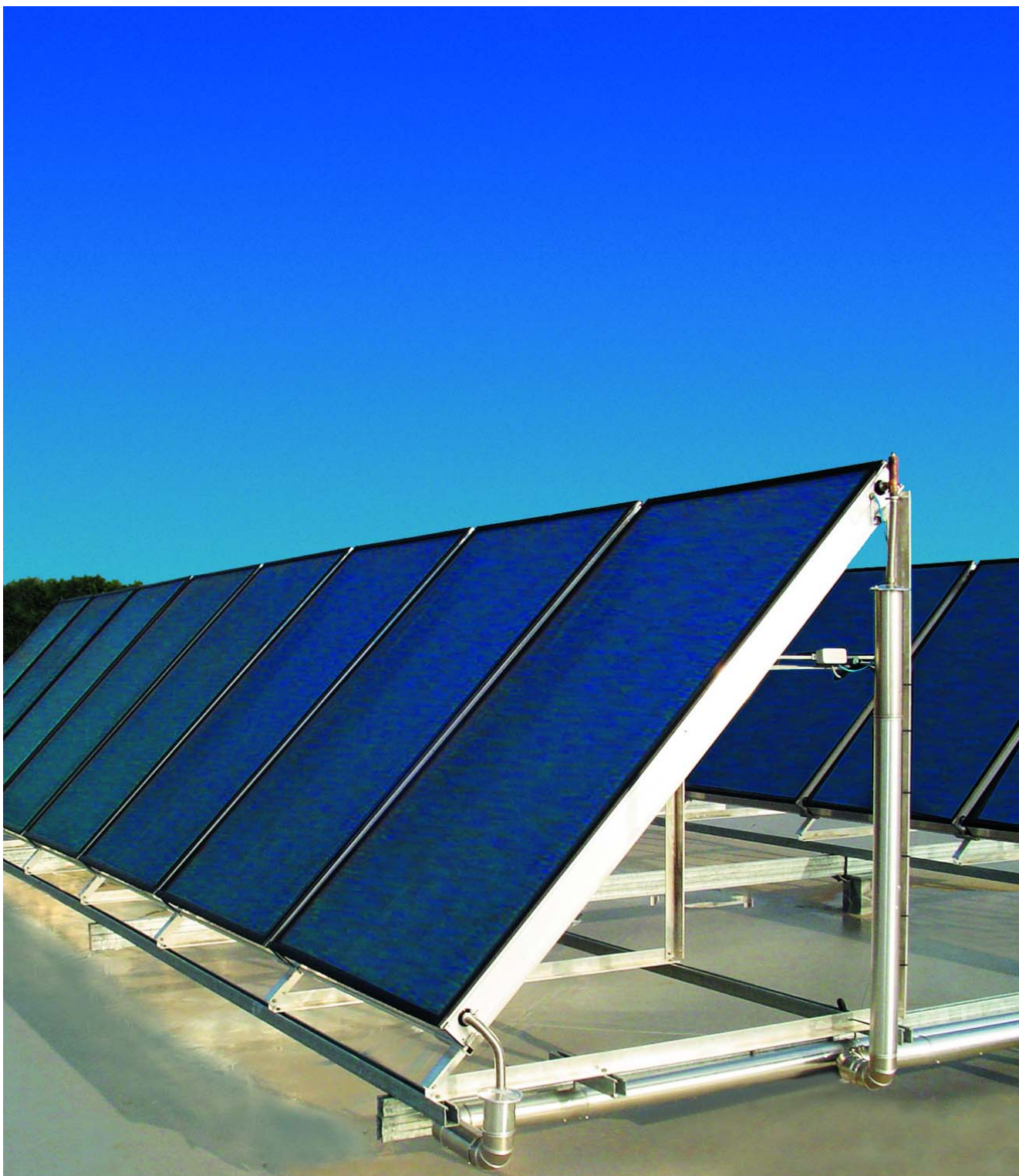
Champs de capteurs verticaux pour des besoins de chaleur importants
